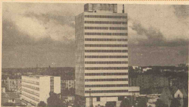
...jedna z zatrzymanych (po co?) budów GPPB, być może ze względu na duże zaawansowanie robót niedługo wróci do task.
