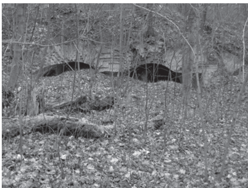
Foto 5: Zniszczony blokhauz obrony bramy fortu
