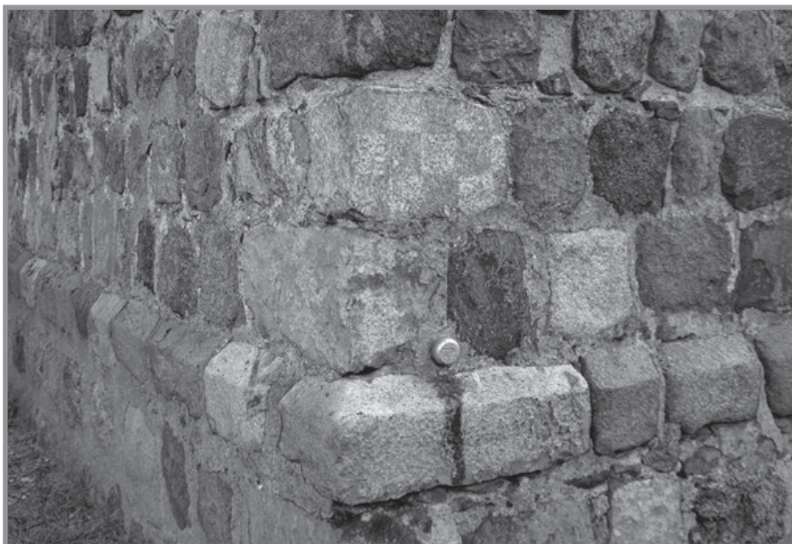
Fot. 45: Moryń, wieża kościoła, kwadra z szachownicą
