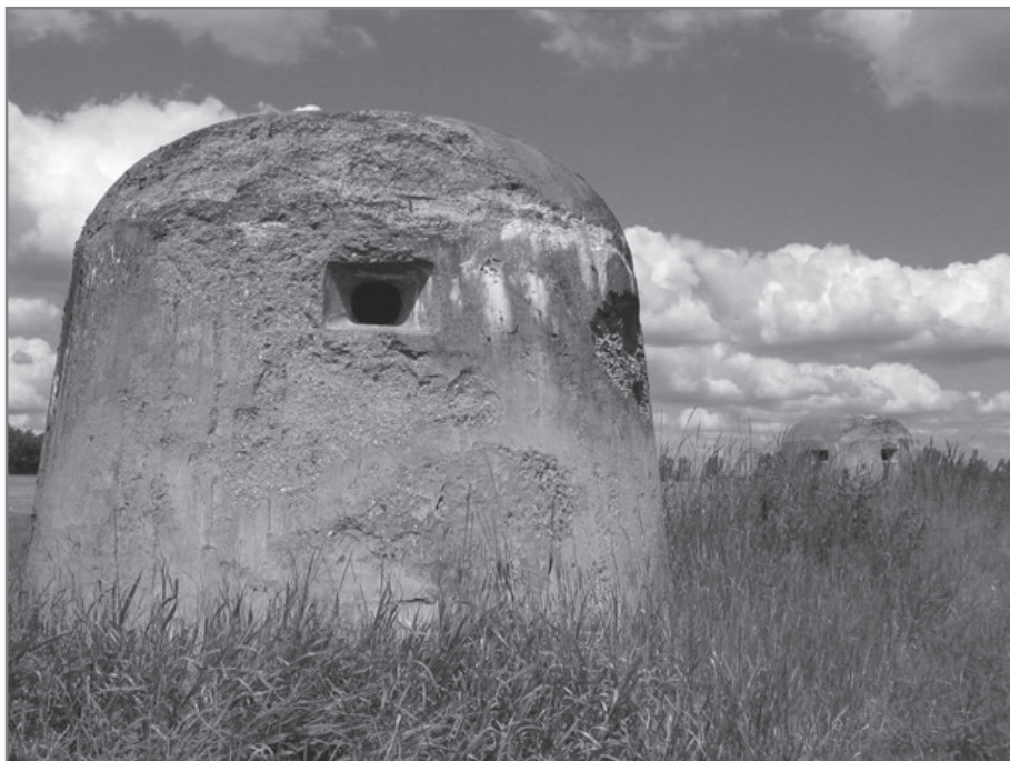
Dwie betonowe kopuły pozoracyjne na pd. od szosy Kaława-Wysoka (stan na 2006 r.). Fot. G. Urbanek
