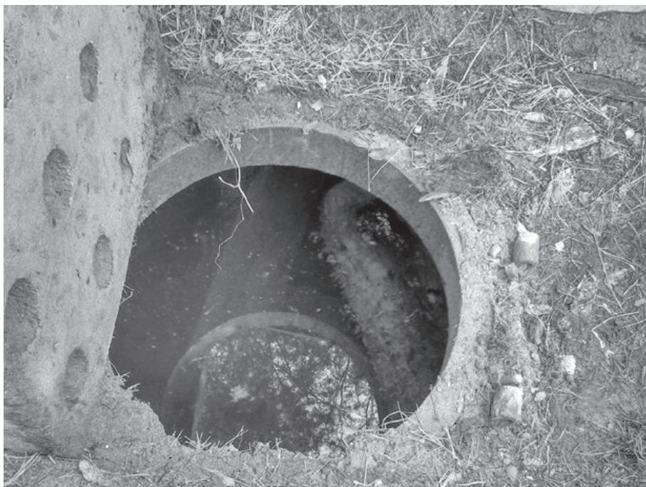
Podziemna instalacja wodna, fot. M. Miotk
