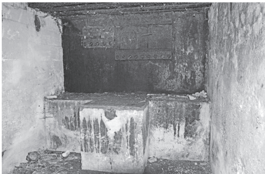
Ryc. 5. Stanowisko dla ckm w izbie bojowej schronu S. 8 w Eisenhüttenstadt (dawniej Fürstenberg). Widoczne zachowane zamknięcia strzelnicy w płycie stalowej 8-centymetrowej grubości, fot. Dariusz Pstuś 2017
