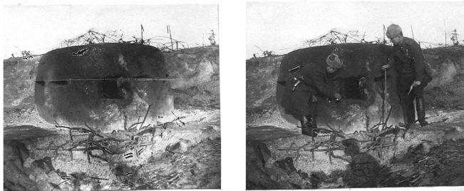
Прямое попадание снаряда в амбразуру. Бетонная стена частично вскрыта и повреждена.
