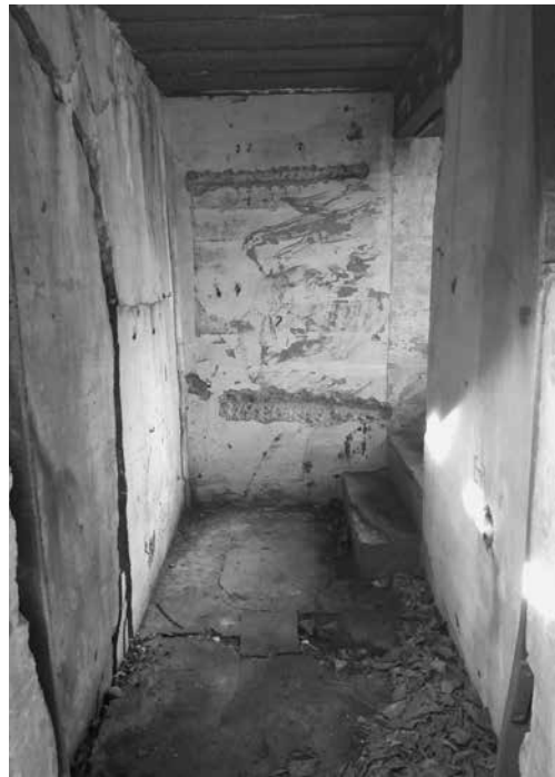
Ryc. 14. Słuza wejściowa. Na ścianie przy wejściu do schronu dostrzegalne są dwa poziome pasy zniszczonego lica ściany. Przepuszczalnie są to ślady po uderzeniu drzwi stalowych typu 17P7, które na skutek powojennego wysadzenia zostały oderwane siłą eksplozji i uderzyły krawędziami w przeciwległą ścianę, fot. K. Motyl 2024
