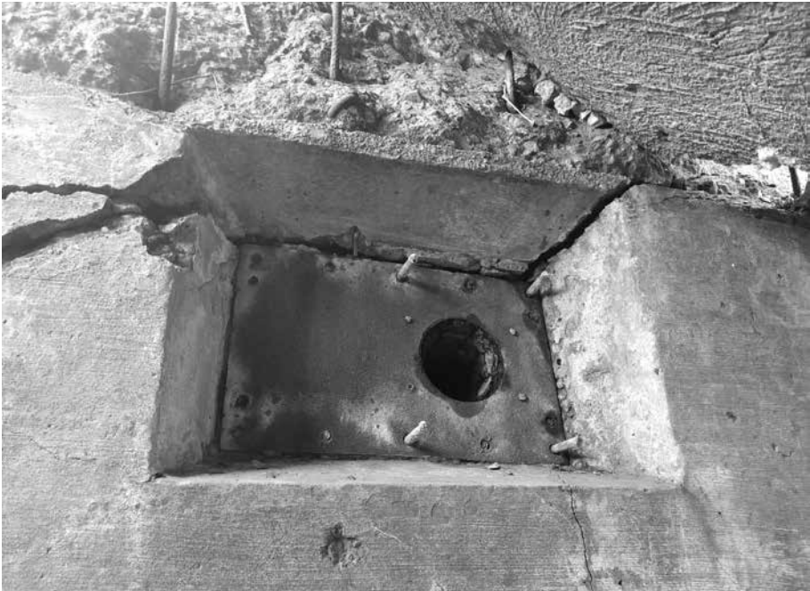
Ryc. 12. Zbliżenie otworu wentylacyjnego pomieszczenia bojowego (nawiew). Wokół otworu zauważalne są 4 kotwy służące do instalacji metalowego adaptera. W rzeczywistości w tym miejscu była większa ilość kotw, która została usunięta przez monterów wyposażenia schronu w 2. połowie 1944 r., fot. K. Motyl 2024
