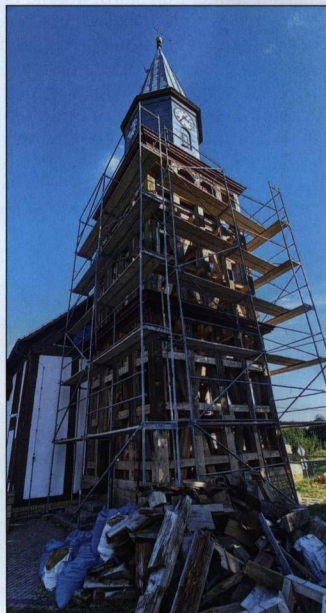
Die Holzkonstruktion war von einem Pilz befallen und musste dringend erneuert werden.
